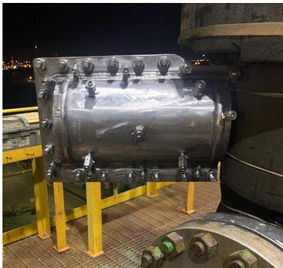
图1. 发生过泄漏的阀门上的临时管道夹具
