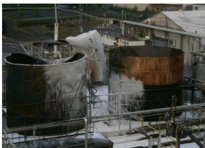
图2. 燃烧后的贮罐
