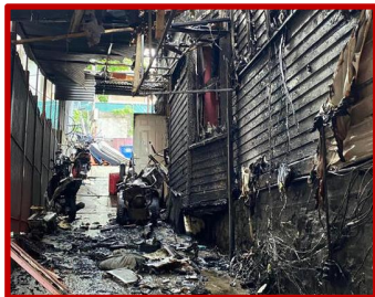
图1：锂离子电池火灾对建筑物造成的损害。
