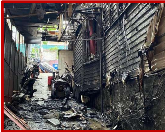
איור 1: נזק למבנה עקב דליקת סוללות ליתיום-איון
