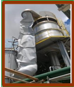
图1：干燥机的进气管在真空中塌陷
