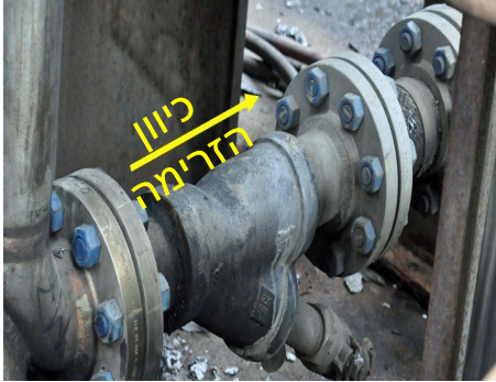
איור 1: מסן פלדה מרותך, בצורה שגויה, לצנרת אל חלד.
